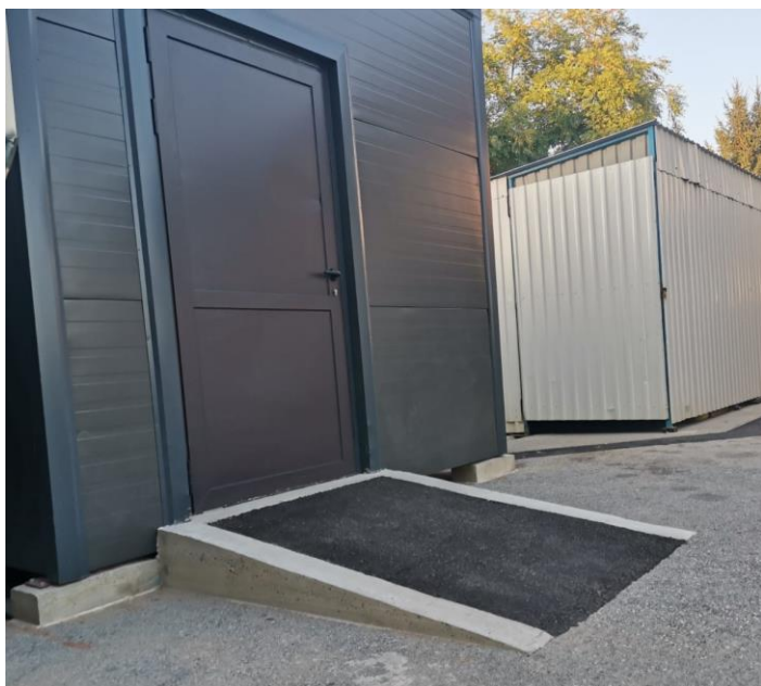
Slika 10. prikazuje nepristupačnu rampu postavljenu na ulaz u javni wc.
