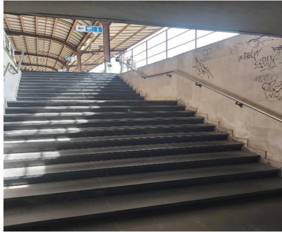
Slika 13. Nepristupačno stubište prema peronima Glavnog kolodvora Zagreb
